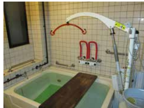
▲入浴施設には、介助が必要な人のためにリフトが備え付けられている
